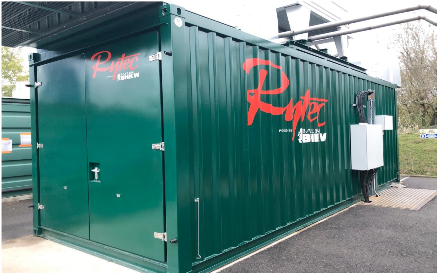
Beispiel: BHKW-Anlage der Bayern BHKW GmbH auf der Deponie Wintzenbach (Elsass)
